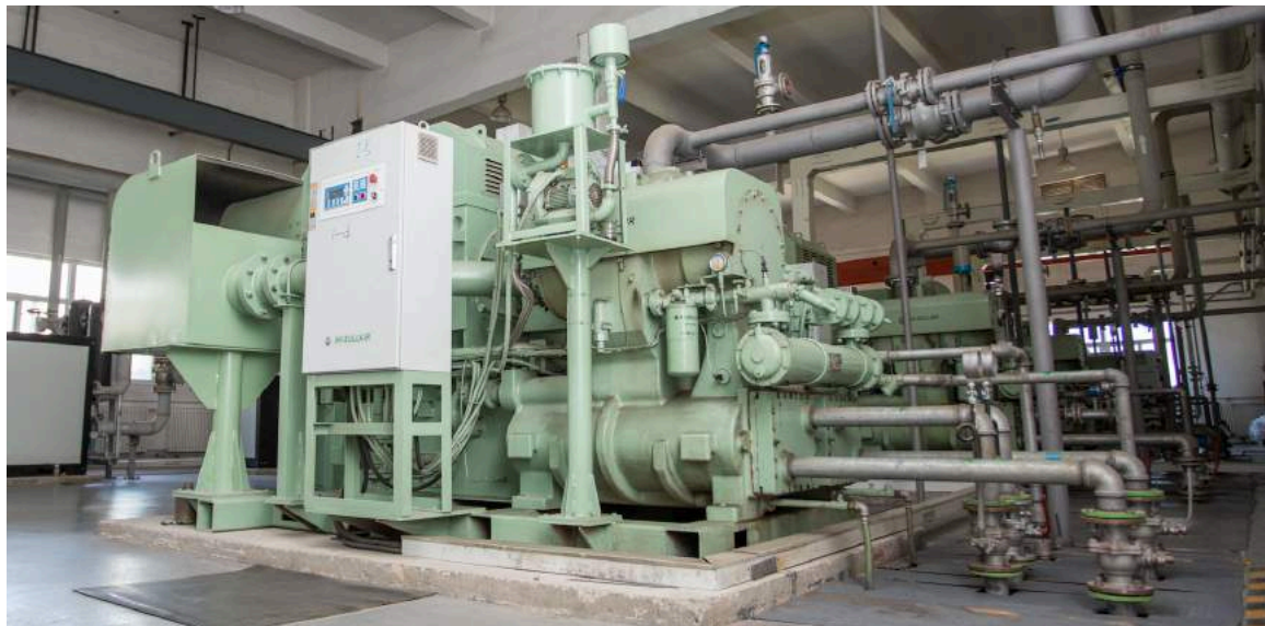
Bild: 0,4MW Turbokompressor i en av Enersizes kunders fabrik i Kina
